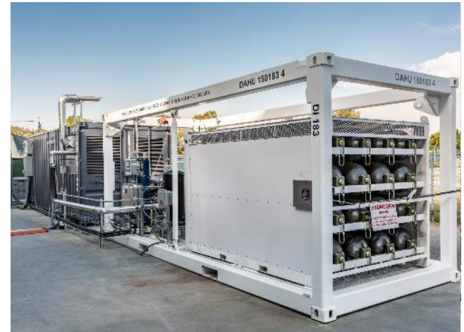
200 kW SOEC unit in Los Angeles, USA
